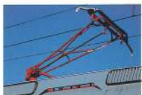
El pantògraf és la peça flexible que permet unir la locomotora o la unitat de tren amb la catenària.
